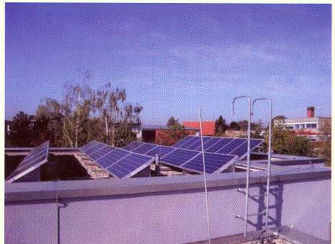
Abbildung 58: Solartromanlage Karl-Dehm-Schule in Schwabach
