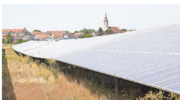
Regionaler Ökostrom für die Region: Durch eine Kooperation der Stadtwerke mit fünf weiteren fränkischen Energieversorgern wurde eine neue Freiflächen-PV-Anlage bei Röhlein errichtet.
