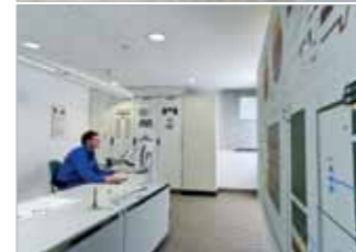
Optimieren der Schaltwarte
