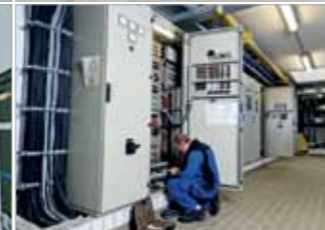
Steuer- und Elektroschränke
