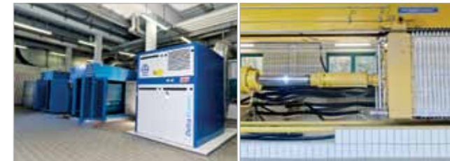
Gebläse für die Belüftung der Belebungsbecken
